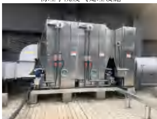
化工学院废气处理设施
