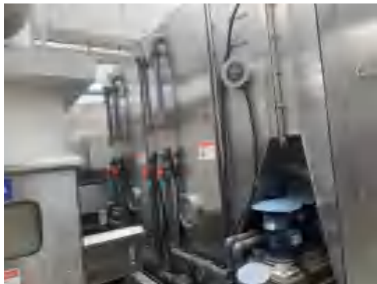
化学系废气处理设施
