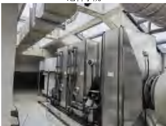
地科学院废气处理设施
