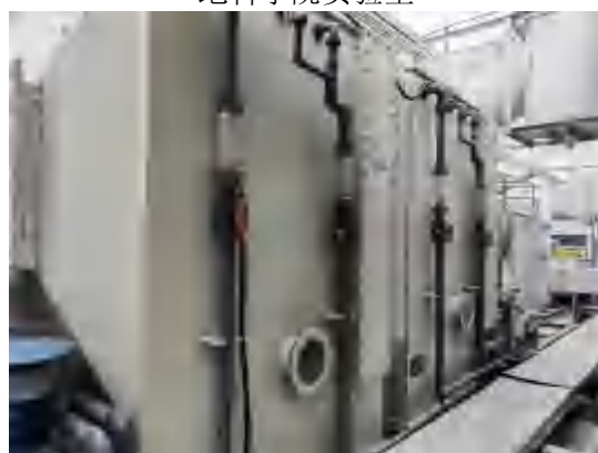
地科学院废气处理设施
