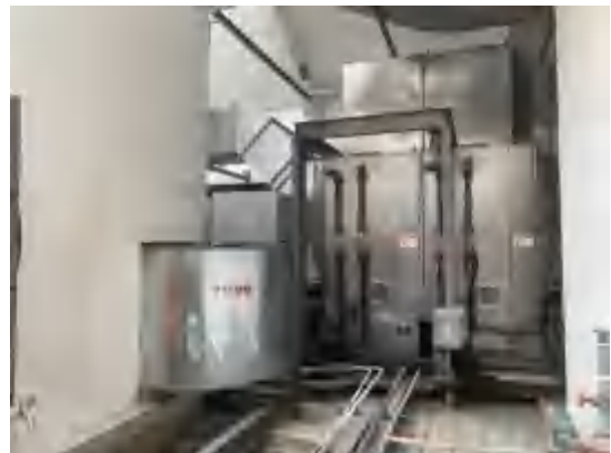
化学系废气处理设施
