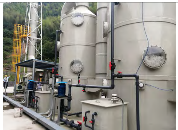
碱液喷淋+水喷淋+光催化氧化+活性炭吸附装置
