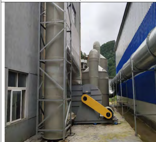
碱液喷淋+水喷淋+活性炭吸附装置
